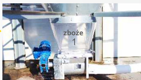
dozownik ziarna podłączony pod silos
